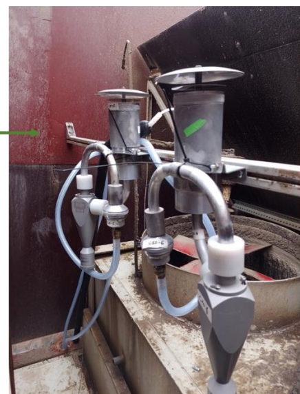
Staalnamepunt van de gewassen lucht
