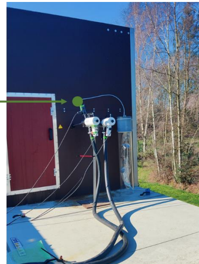
Staalnamepunt van de gewassen lucht
